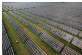
Centrale photovoltaïque de 40 MW, située à Leipzig en Allemagne. 400 000 m 2 de modules répartis sur 110 hectares, correspondant aux besoins annuels de plus de 10 000 foyers.
